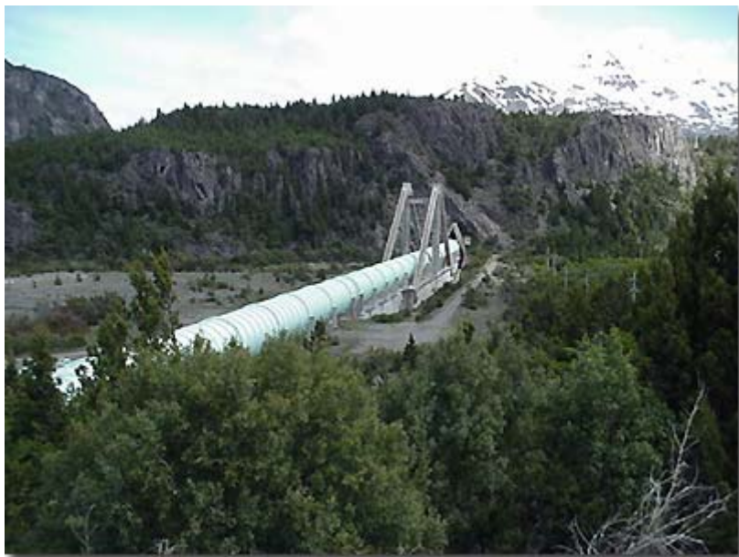
Ductos de la represa Futaleufú. Foto: Fernandez Montoni
